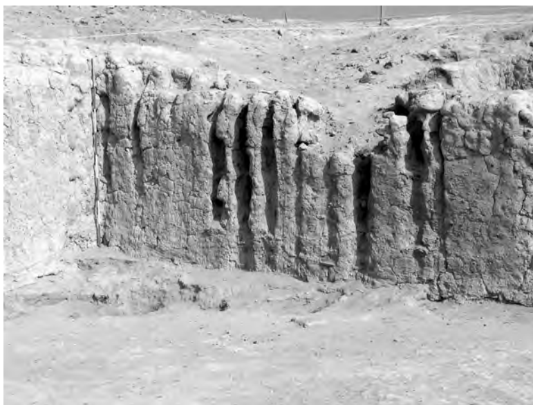
Figura 9. Sección de muro en adobes paniformes dañado por el escurrimiento de agua (excavaciones CISRAP, foto Bachir Bacha, 2004).
