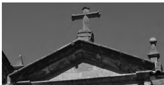
Figura 12. Acrótera sobre el frontón nuevo del Monasterio de Santa Catalina.
