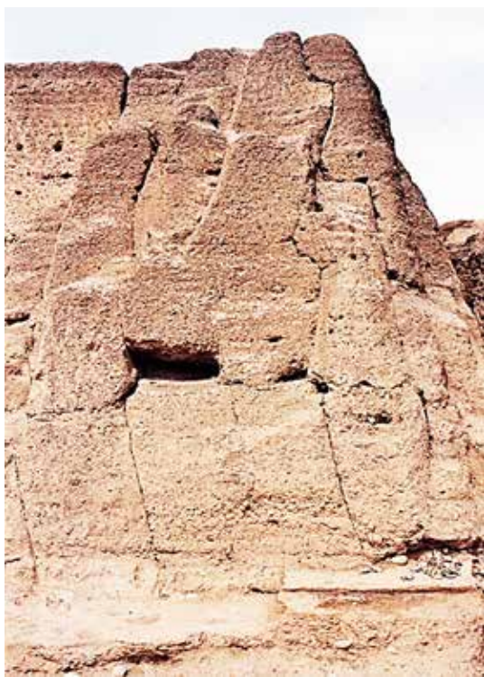
Foto 5: Muro de la esquina suroeste externa destacando las trabazones por adosamientos consecutivos explicados.
