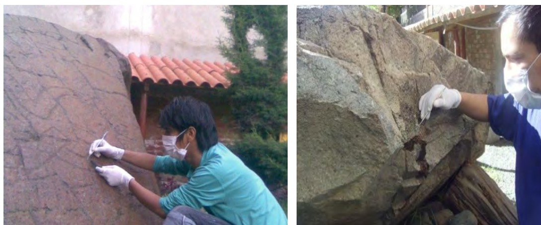
Figura 04. Proceso de limpieza en forma mecánica de líquenes y fragua de cemento se realizó con sumo cuidado
