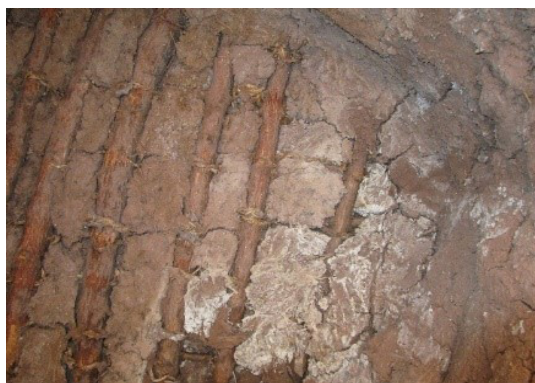
Figura 31. Cubiertas con rollizos de Qishuar amarradas y trenzadas con sogas de paja, E.F-N°9 del sector "I".
