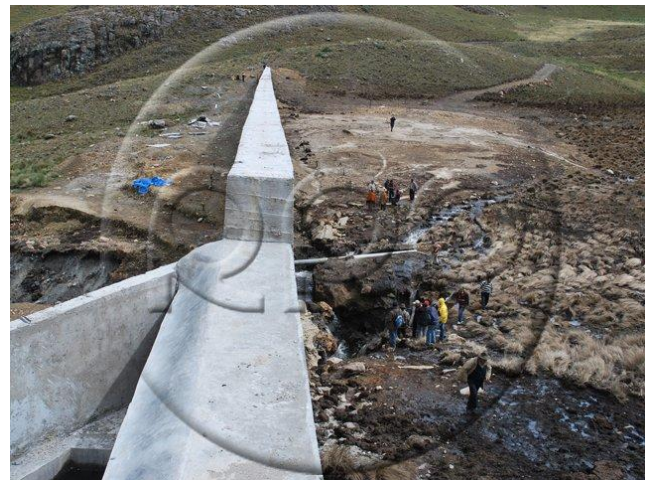
Fig. 3. Laguna la Encantada. Forado del dique de contención, [5].
