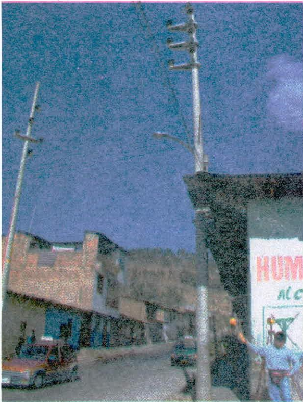
Foto 1 - Ubicación del medidor de campo magnético radiado por la línea de 10 KV, en Cajamarca.
