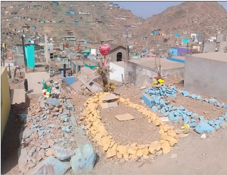
Figura 9. Construcción de nichos con piedra en el cementerio Nueva Esperanza. Archivo personal.
