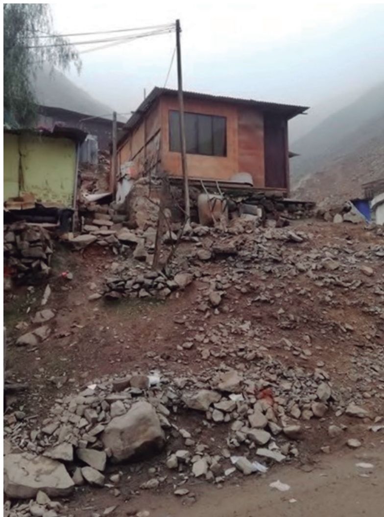
Figura 3. Imagen de la Vivienda asentada sobre material inestable.
