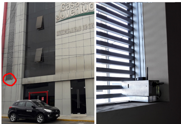
Figura 4: A la izquierda, frontis del lugar de emplazamiento del medidor en la calle Los Heros. El círculo en rojo indica la posición en la rejilla de ventilación donde fue instalado el medidor. A la derecha, vista interior del medidor instalado.
