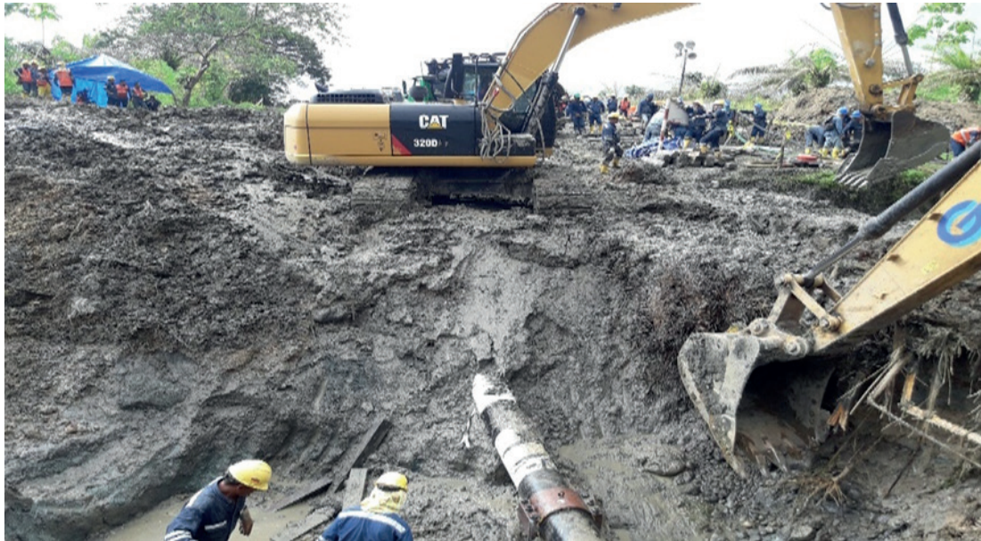
Figura 1. Rotura de ducto del Poliducto Esmeraldas-Santo Domingo, Ecuador.
