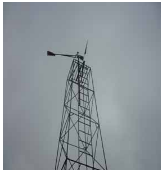
Figura N.º 5. Instalación del microaerogenerador en la EAP de Ingeniería de Minas de la UNMSM.
