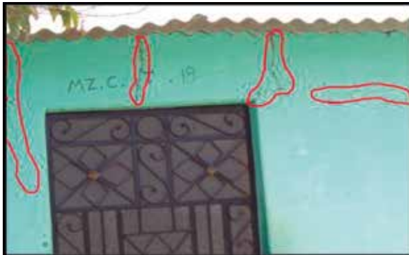
Figura N° 9. Rajaduras diversas. La Figura N° 10 es real y nos quedamos asombrados cómo una persona de avanzada edad pueda residir en una vivienda como esta, que ha sufrido rajaduras y la caída de su revestimiento.
