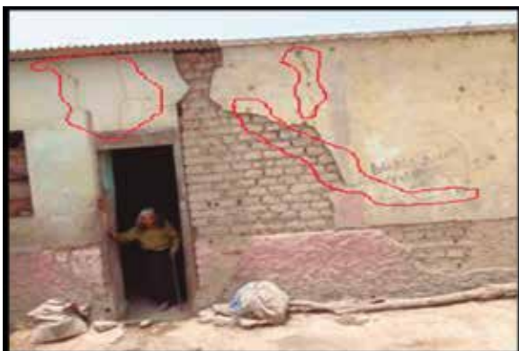
Figura N° 10. Rajaduras y caída de su revestimiento. asombrados cómo una persona de avanzada edad pueda residir en una vivienda como esta, que ha sufrido rajaduras y la caída de su revestimiento.
