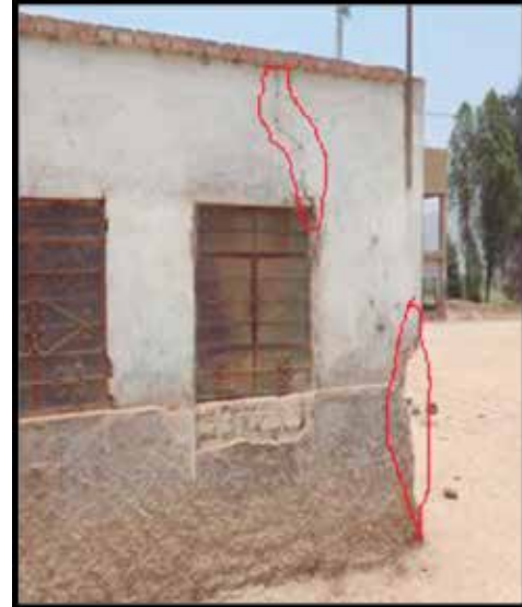
Figura N° 11 vivienda con rajaduras. No solo las viviendas construidas a base de adobe o tapial sufren rajaduras, sino también viviendas construidas de material noble, debido a que no se hizo un estudio de suelo para ver la resistencia.
