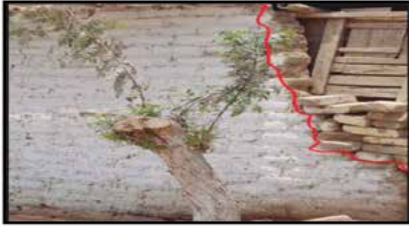
Figura N° 8. Rajaduras críticas. Vemos las rajaduras en diversas direcciones, es una vivienda construida a base de adobe revestido con barro.
