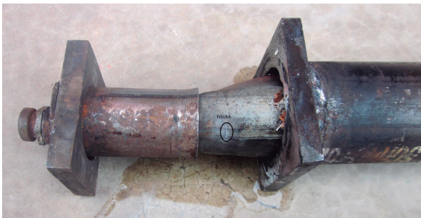
Figura N° 6. Fisuramiento del perno cerca de su cabeza en tubo de 40 mm de diámetro y para 1 pie de anclaje.
