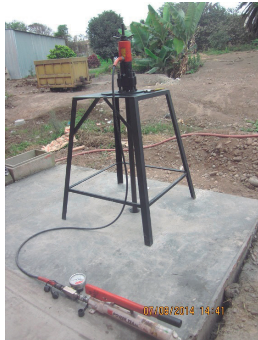
Figura N° 1. Equipo de arranque instalado.
