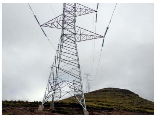
Figura N° 1: Líneas de transmisión. Proyecto Línea de transmisión de 220 kv. Cajamarca–Carhuamayo
