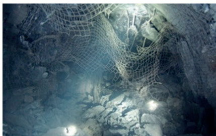
Figura 5. Desprendimiento de rocas en hastiales y corona
