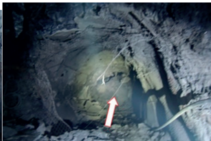
Figura 6. Daño al sostenimiento en corona y hastiales
