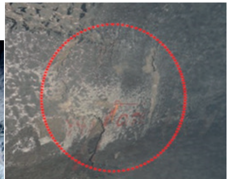
Figura 7. Daño al shotcrete
