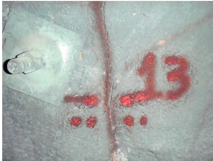
Figura 9. Progresiva 1+107. Se evidencia fisura vertical en el concreto lanzado. Hastial izquierdo con dirección hacia aguas abajo.
