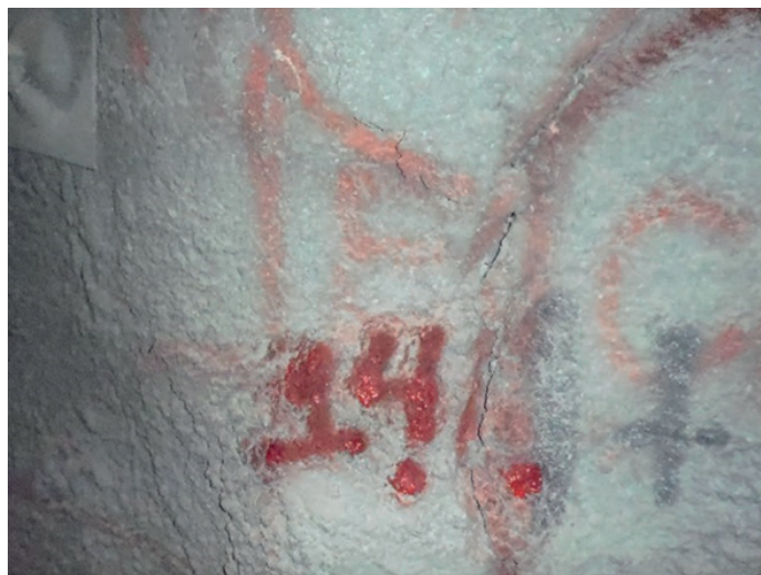
Figura 10. Progresiva 1+105. Se evidencia fisura vertical en el concreto lanzado. Hastial izquierdo con dirección hacia aguas abajo.
