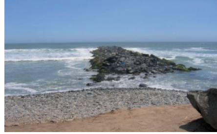
Figura N.º 2. Muestra un espigón destruido por la erosión
