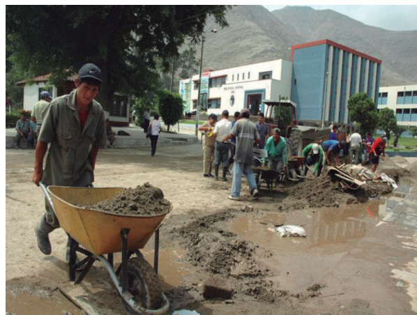
Figura N.º 8: Obsérvese al personal de la universidad haciendo limpieza de los materiales del huayco en la entrada principal.
