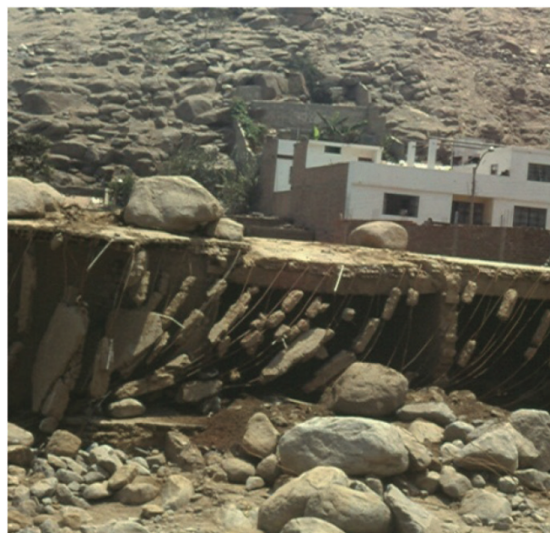
Figura Nº 6: Destrucción de casas de material noble (quebrada Pedregal 1987).
