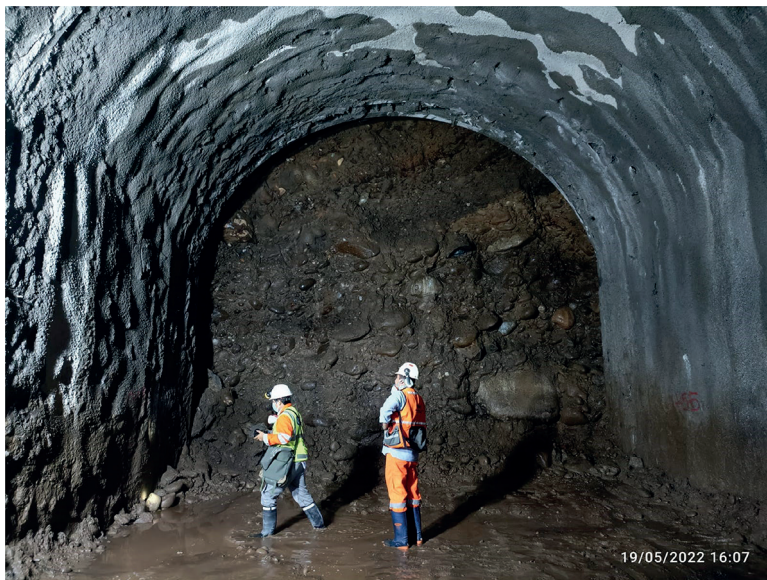
Figura 12. Tipo de terreno de suelos no consolidados, condición muy mala
