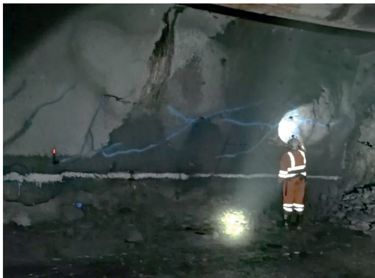
Figura 15. Identificación y pintado de las fisuras generadas en el SRF de acero Nota: Inspección para el pintado de las fisuras y grietas generadas en el SRF de acero en el tajo A 1150 (excavación temporal). Esto facilita la visión de todo el personal que ingresa a este tajo
