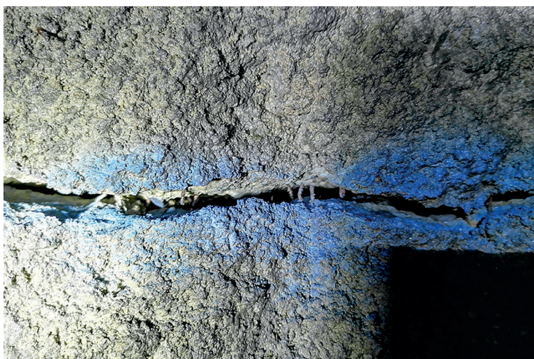
Figura 13. SRF de acero con grietas expuestas
