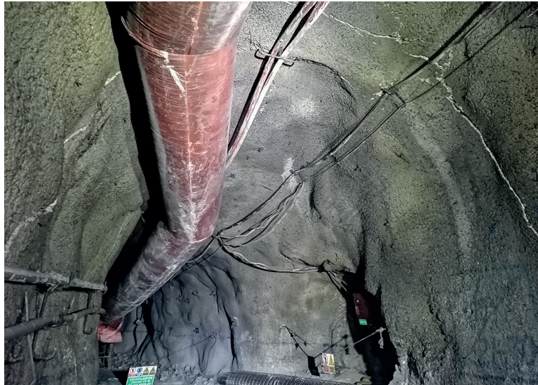
Figura 20. Excavación subterránea permanente con shotcrete agrietado en la mina Pallancata Nota: SRF de polímero con agrietamiento transversal, en este caso se mantiene la ductilidad posagrietamiento para una excavación permanente
