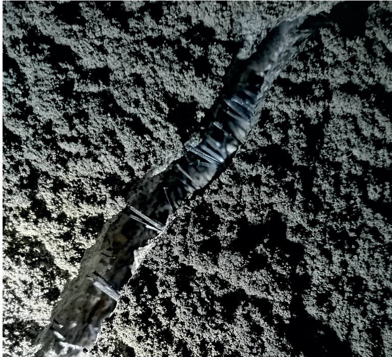
Figura 22. Agrietamiento de SRF de polímeros
