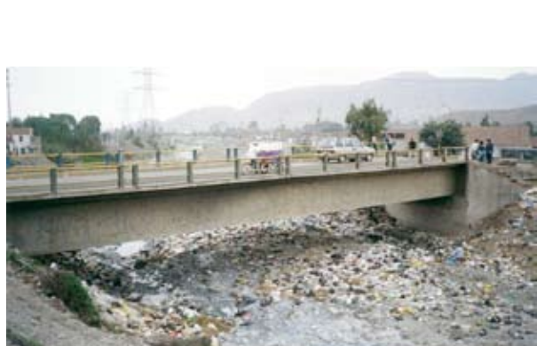
Foto N.º 16. Se observa la fuerte contaminación por diversos desechos sólidos de las riveras del río.
