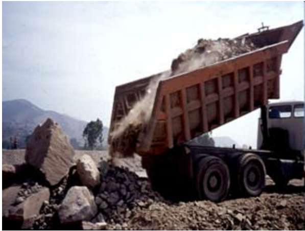
Foto N.º 18. Para poder rehacer el dique roto, se trajo material sin mucha selección y sin mayor apoyo técnico, sólo se tapó el forado.
