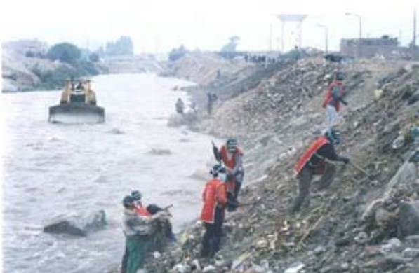
Foto N.º 15. Afectación del río por actividad antrópica, donde los pobladores arrojan basura y desmontes, acortando el cause del río, colmatándolo y contaminando sus aguas.
