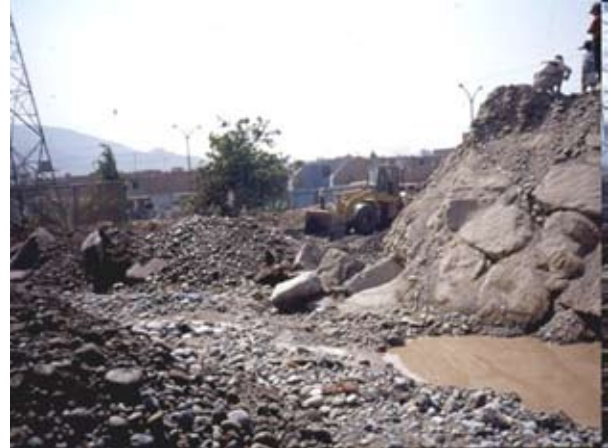
Foto N.º 6. La inundación en San Diego se inicio con la rotura de la defensa ribereña cerca de un poste de alta tensión.
