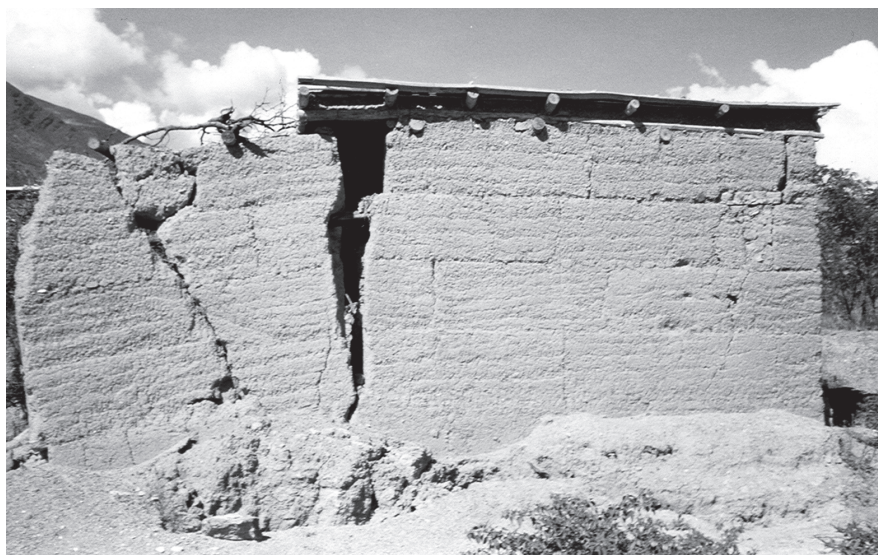
Foto N.º 5. Casa de un comunero que está siendo destruida por el deslizamiento de suelos.
