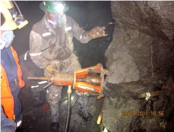
Foto Nº 3-2: Equipo de arranque en acción
