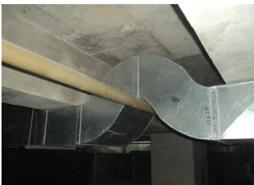
Figura N° 2. Cuando no se tienen definidas las alturas y recorridos de las instalaciones, en campo se tienen que dar soluciones no óptimas.
