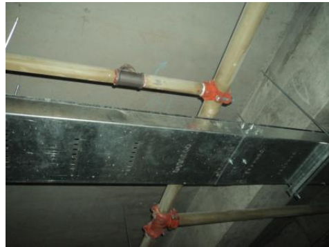
Figura N° 3. Un problema típico, no tomado en cuenta por los subcontratistas de instalaciones, es colocar las tuberías de agua contra incendio por encima de las bandejas eléctricas.
