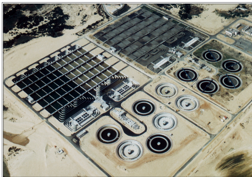
Figura N.º 2. Vista panorámica de la PTAR Shafdan - área 45 ha (pretratamiento, reactores biológicos y clarificadores).
