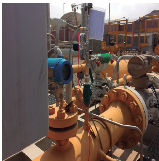
Figura 1. Instalación del punto de muestreo de GN.
