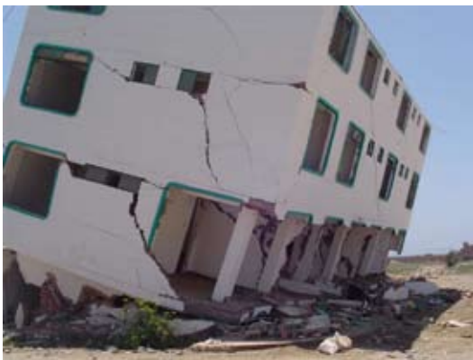
Figura N.º 1. Vivienda afectada.
