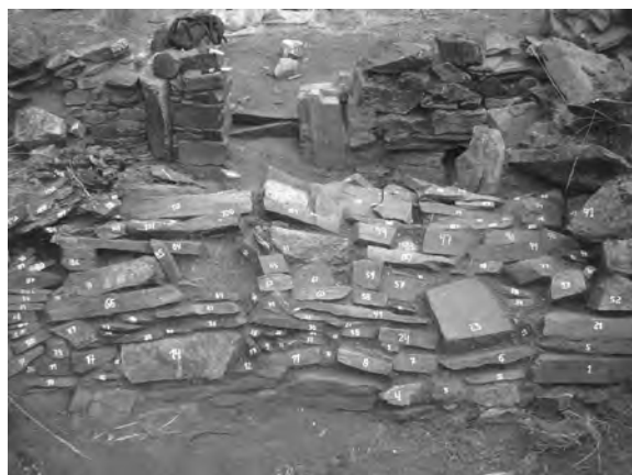
25. Vista de un muro colapsado en el Recinto 6 del Conjunto 11. Nótese el registro número para proceder al desmontaje y posterior restitución.
