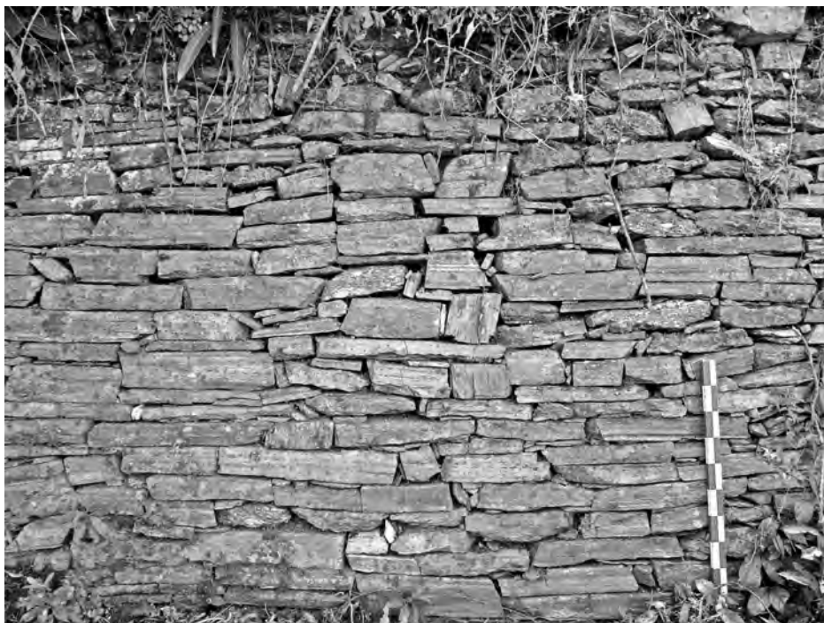
Figura 20. Muro con aparejo hecho de esquistos de formas regulares. Sector VIII de Choquequirao.
