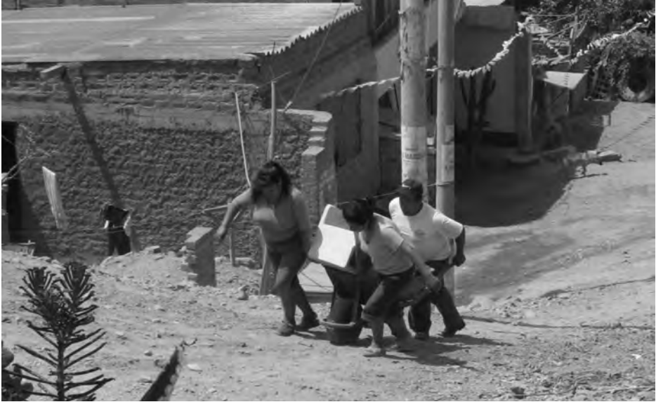
A.H. Sector 1 Grupo 1, Villa El Salvador. Traslado de aparato sanitario para su posterior instalación.
