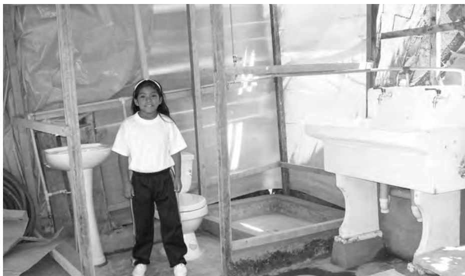
A.H. Villa Victoria, Villa El Salvador, aparatos sanitarios instalados, conformando un espacio de aseo.
